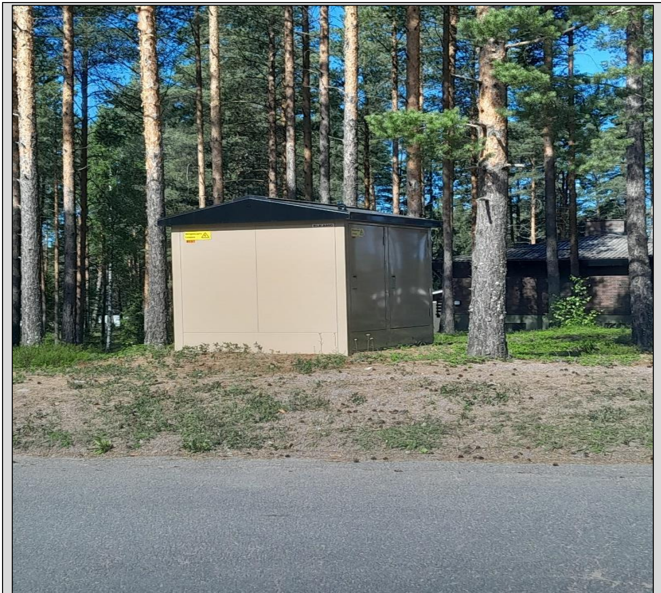
Kuva 9. Puistomuuntamo Rinnetien päässä Säkylänharjulla.
