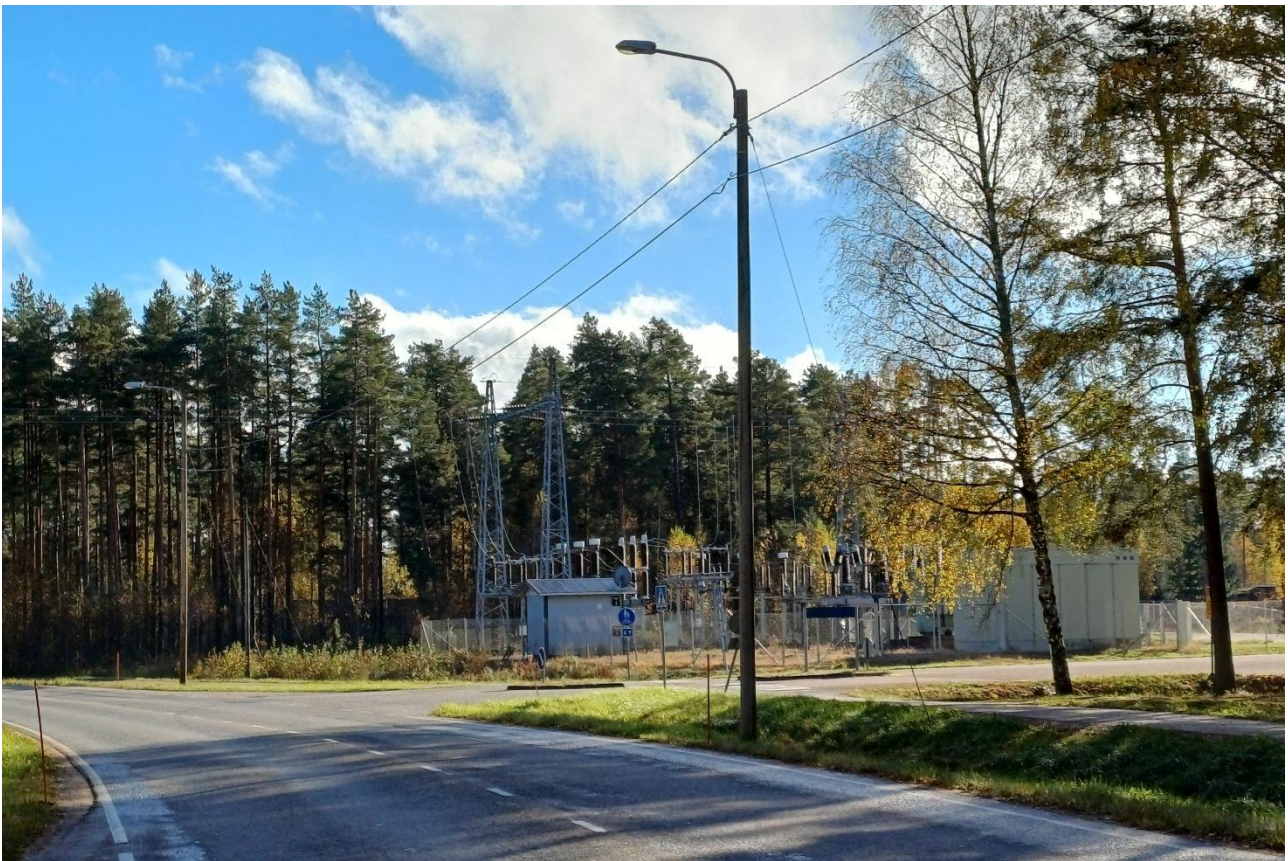
Kuva 1. Euran sähköasema pohjoisesta päin kuvattuna. Kuva: Paula Salonen, Envineer Oy.
